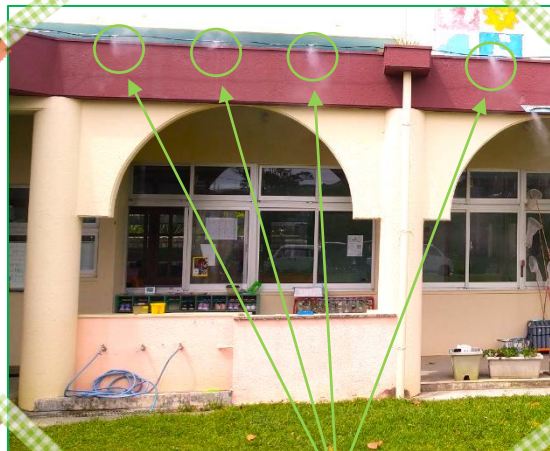
【設置したミストノズル】
